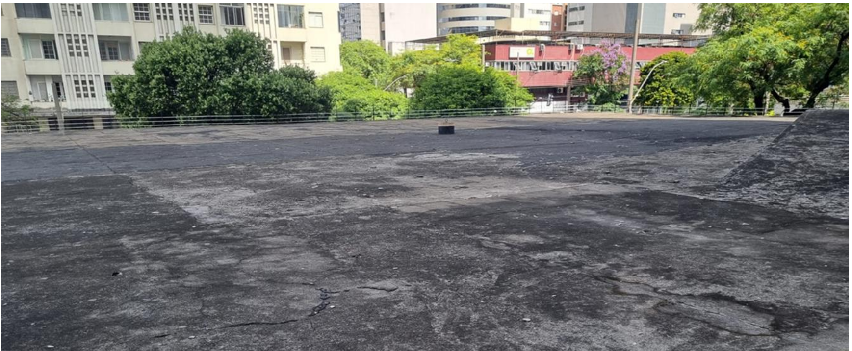
Rachaduras e infiltração na laje superior externa do JK (cobertura do IHGMG).
